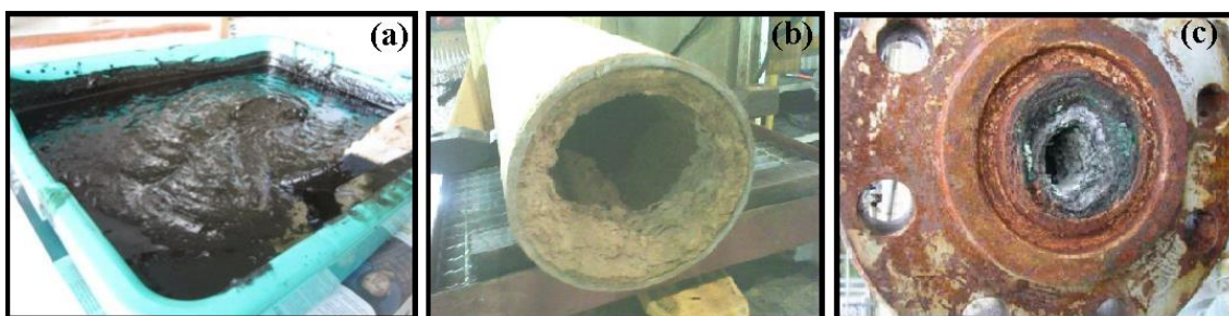
Figura 4 – Borra oleosa e seu acúmulo (a) Borra oleosa (b) Tubo com incrustação por borra oleosa (c) Flange com entupimento parcial por borra oleosa. Fonte: (a) [47]; (b) [31]; (c) [42]
