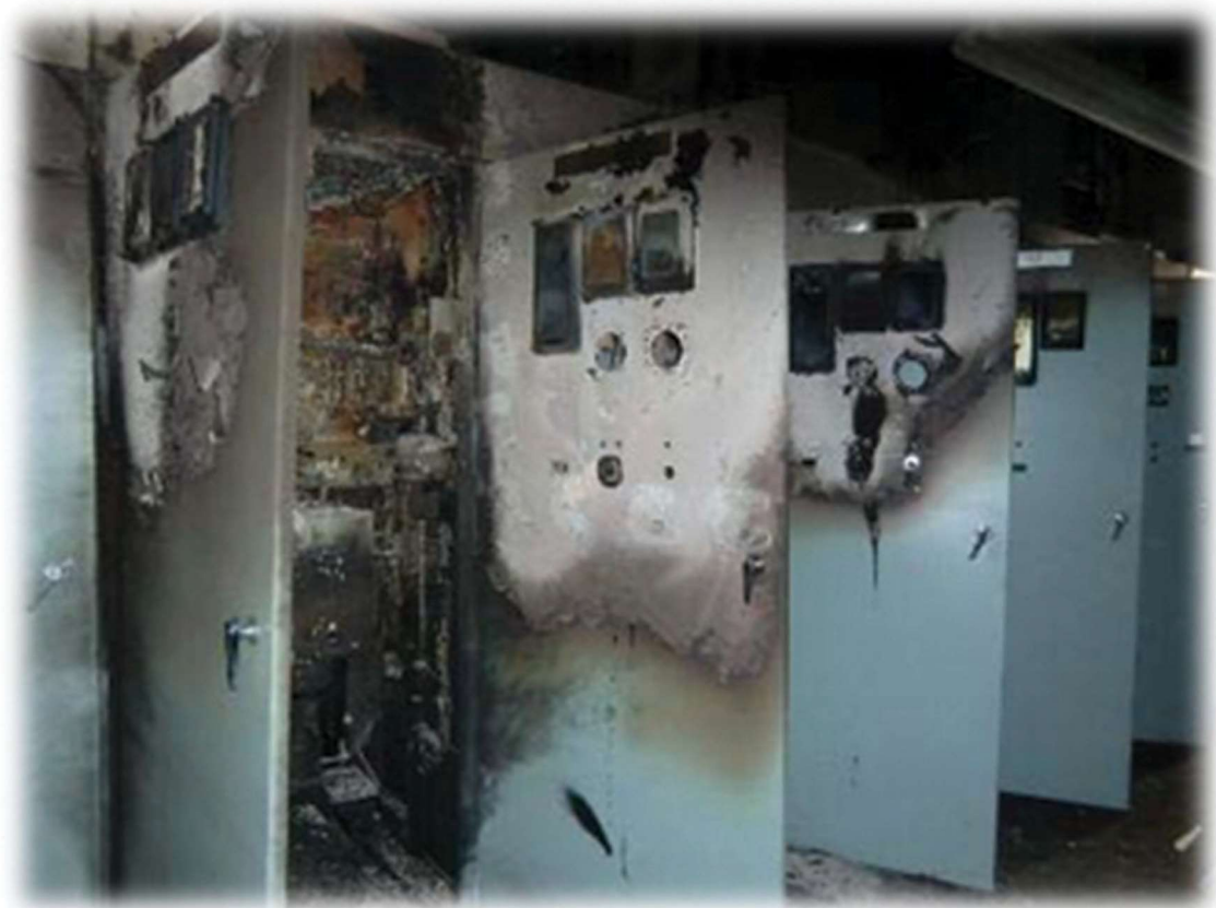
Figura 3 - Gabinete elétrico com o setor onde começou o incêndio e outros gabinetes prejudicados (KABASHIMA, KASAHARA, 2019).
